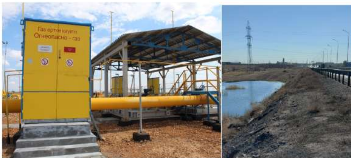
Рисунок 4 - Газораспределительная станция по ул. Гоголя (слева) и трасса А-17 (справа)
